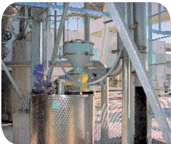
Een moderne waterzuiveringsinstallatie.
